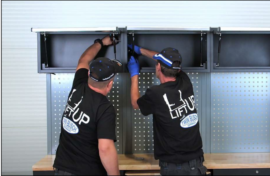
Figure : Armoires suspendues
